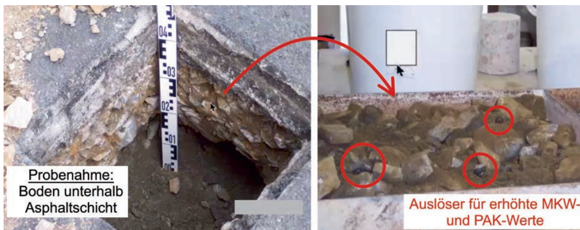
Abbildung 5 Fehlerhafte Untersuchung und Falschinterpretation durch unbrauchbare Probeentnahme (12)
