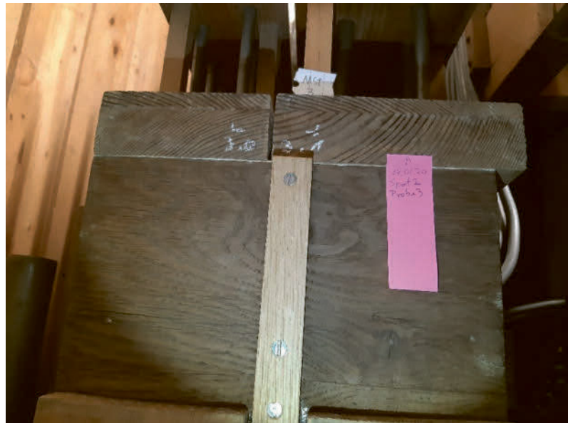
Abb. 11 Probestelle Messstelle 2, Windlade, Endstück, Hirnholz, vertikale Fläche mit verschimmelter Leimfuge, ca. 180 cm Höhe über Fußboden, C-Seite
