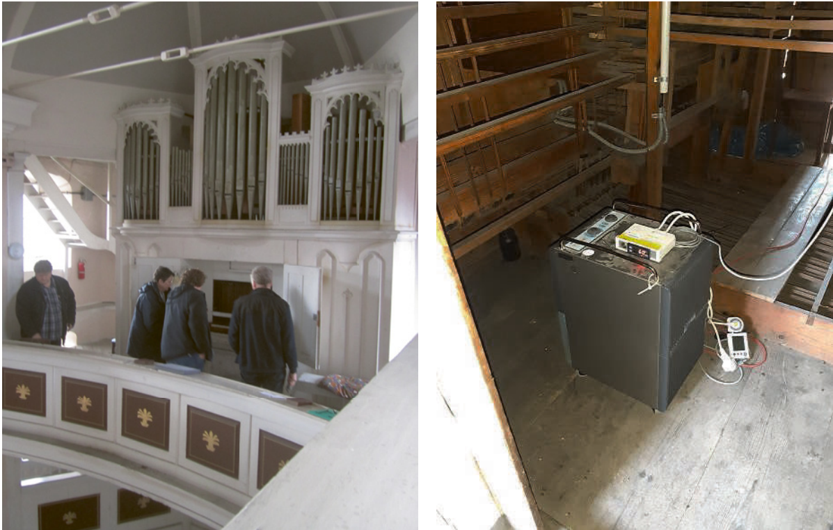
Abb. 61 Wöllnitz, links Ortstermin (2016), rechts der Raumlufentfeuchter mit dem Vorschaltgerät für die gezielte Zuschaltung des Entfeuchtungsprozesses in der Orgel (2020)
