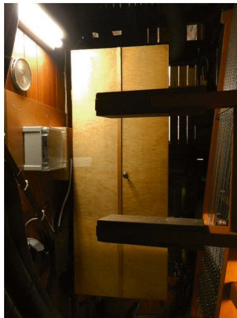
Abb. 75 (links) Rückseite des Orgelgehäuses von Westen aus betrachtet. Hinter der offenen Tür befindet sich der (rechts) Schaltschrank, dessen linke Tür als Probestelle für diesen Test verwendet wurde.
