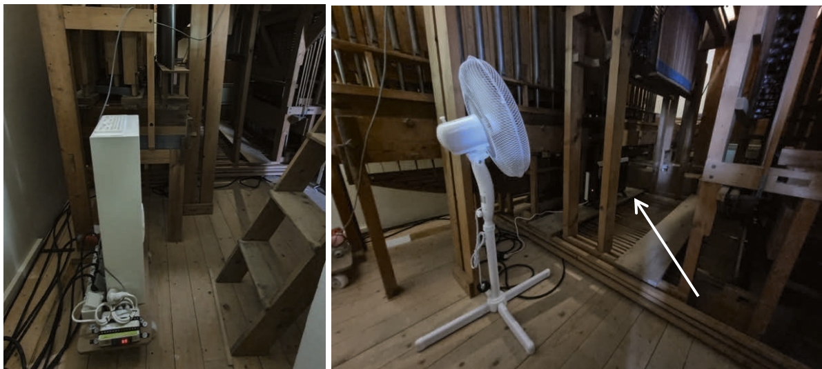
Abb. 49 links: mobile Anschluss- und Regeleinheit, rechts: mobiler Lüfter und Elektroheizkörper
