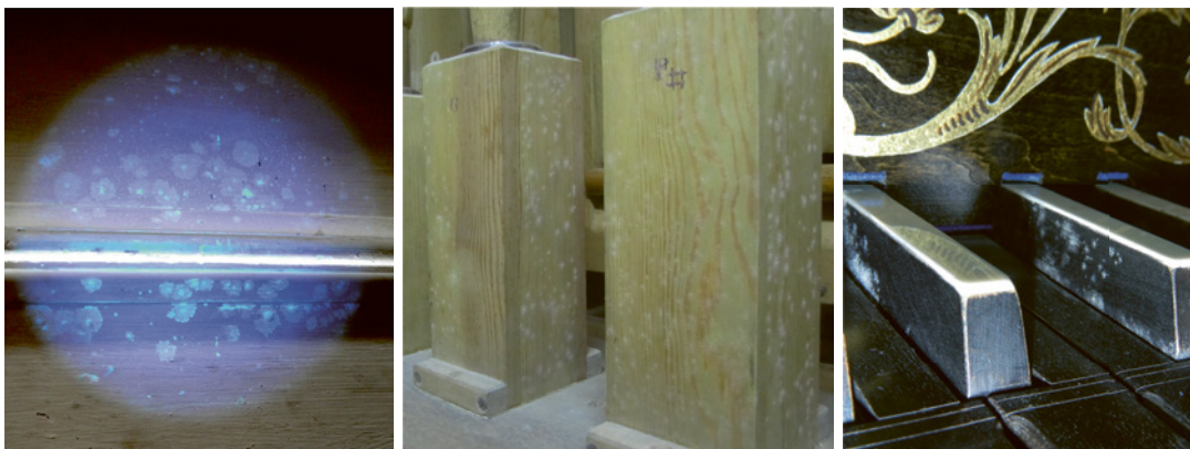
Schimmelbefall: links unter UV-Licht, Mitte u. rechts mit bloßem Auge zu erkennen
